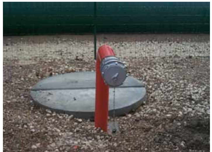
Exemple canalisations d'aspiration fixes Photo n°9
